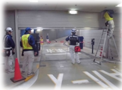
防火設備点検(法定点検)
