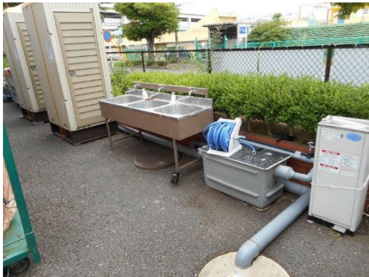
沈殿槽設置の排水処理設備
