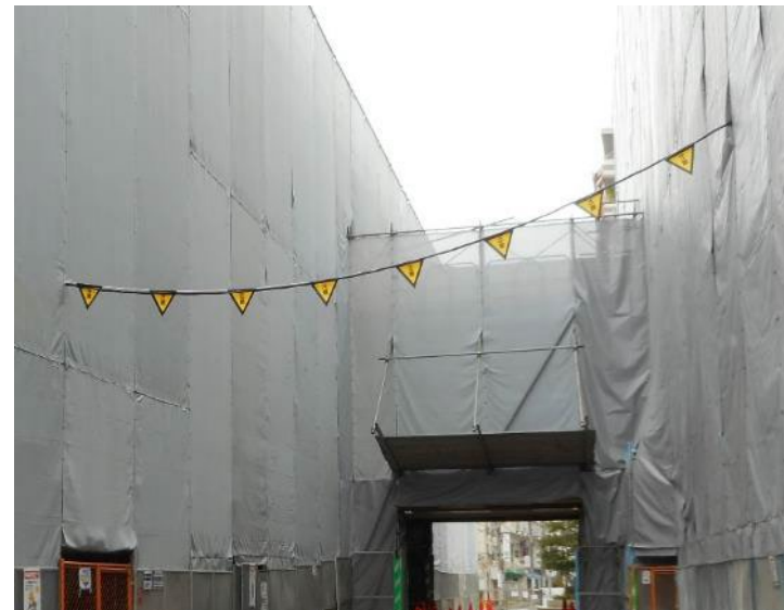
屋外架空 電源ケーブル 注意喚起表示
